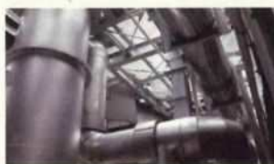
プラント配管
